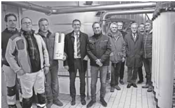
Freuen sich gemeinsam über die Ultrafiltrationsanlage: Wassermeister Rene Kantwerk, stv. Wassermeister Maik Schlenstedt, Dirk Strecker von Strecker Wassertechnik, Bürgermeister Jörg Kaltenbach, Marc Strecker von Wassertechnik Strecker, Planer Wolfgang Schmid, Dirk Krafft vom Gesundheitsamt, Ortsvorsteher Emil Buschle, Josef Mayer-Wolf vom Wasserwirtschaftsamt und Stadtkämmerer Gebhard Läufer (von links).
